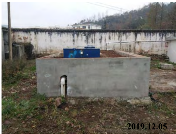
院内污水处理站
